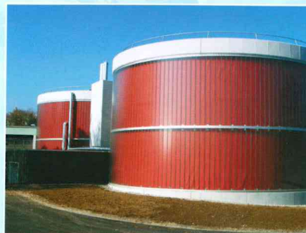
Faulraum und Schlammstapelraum
